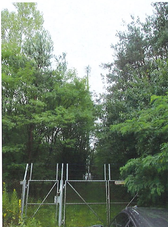
Zał. nr 1: Widok ogólny instalacji radiokomunikacyjnej.
