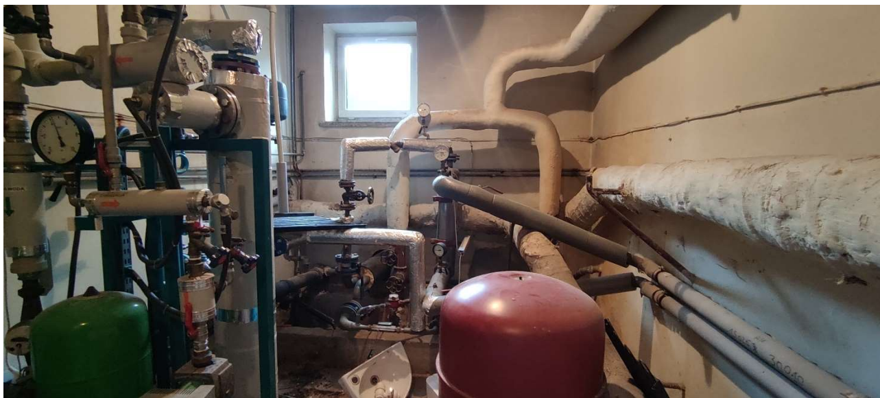
Widok węzła cieplnego nr 1 w segmencie A (c.o. i c.w.u.)
