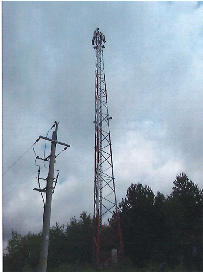
Zał. nr 1: Widok ogólny instalacji radiokomunikacyjnej.
